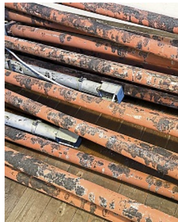
Manche verbrannte Schuhsohle ist auf den ausgebauten Fuß-Heizstäben sichtbar.
